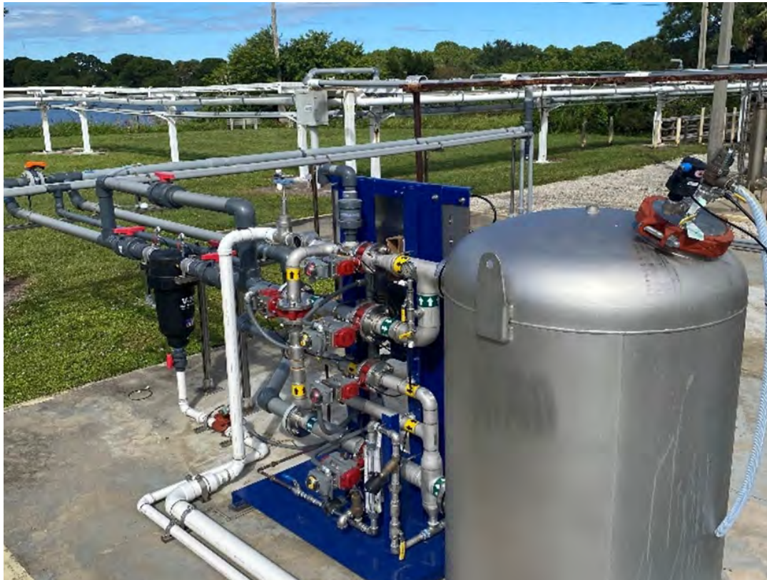
市と提携し1日当たり30m 3 の再利用水を市に供給 (Palm Bay Factory)
