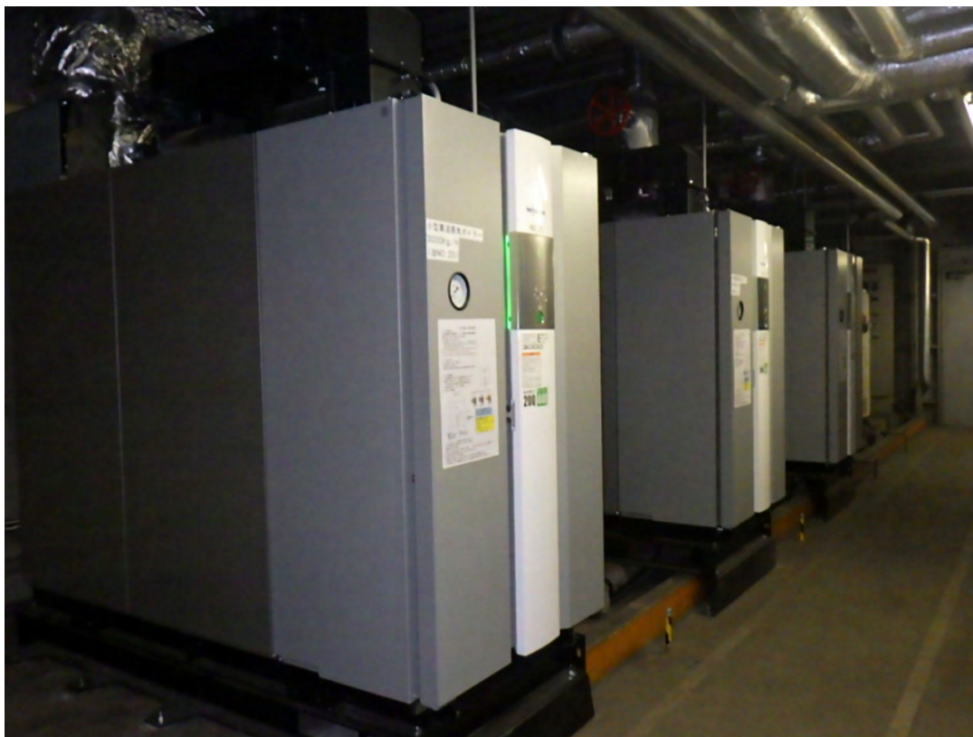
灯油からLNG燃料へ切り替えたボイラー (西条工場)
